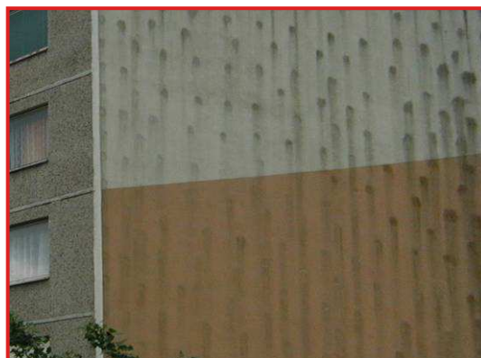
Obr.: Část štítu zatepleného objektu se silným znečištěním fasády nad talíři plastových hmoždinek
