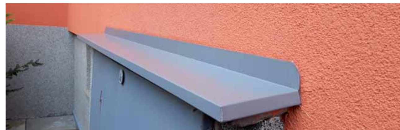
Stříška nad elektrickou skříň
